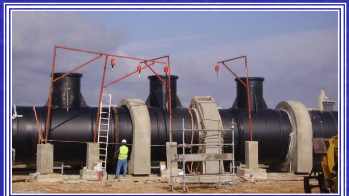
Circuito de refrigeración de la Central Térmica de Algeciras (España). Vista del tramo difusor Di=2.400 mm
